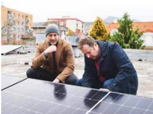
Nově osazenou fotovoltaiku na DDM Rozmarýn si prohlédli radní Tomáš Sarnovský a zástupitel Vladislav Liška. Foto: Michaela Rozsypalová
