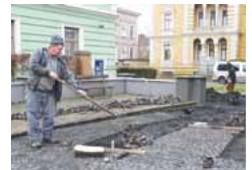
Pokládka nového chodníku u posezení nacházejícího se poblíž ZUŠ. Nyní již je hotovo. Foto: Radim Tuček
