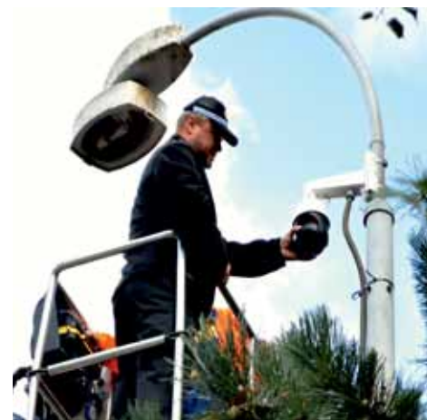
Technik městské policie Pavel Frk při instalaci kamery, která monitoruje dění v okolí diskotéky Severka. Foto Andrea Pěkná
